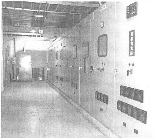
高壓站控制面板
