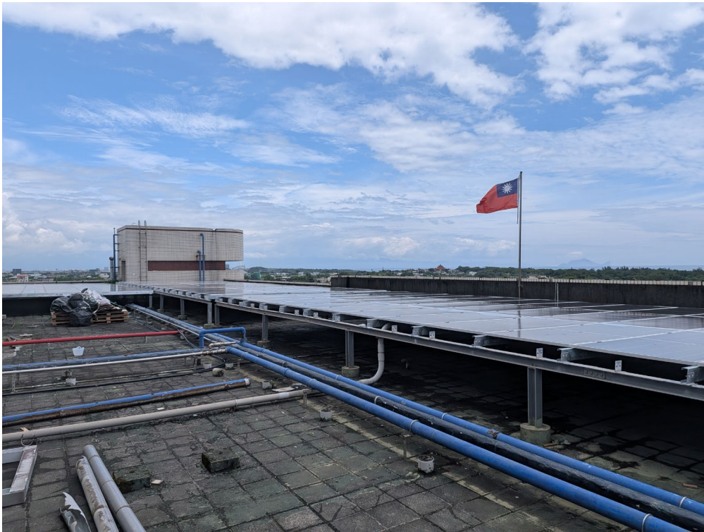
圖：本院屋頂太陽能光電板實景
